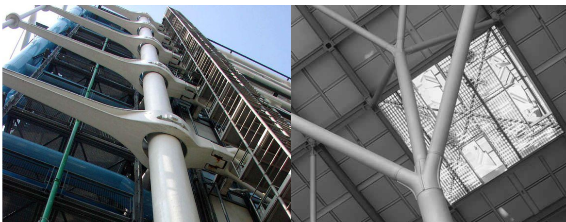
Figura 36 – Esempi di cast steel, Pompidou Centre di Parigi (a sinistra) e International Airport di Stoccarda (a destra)
