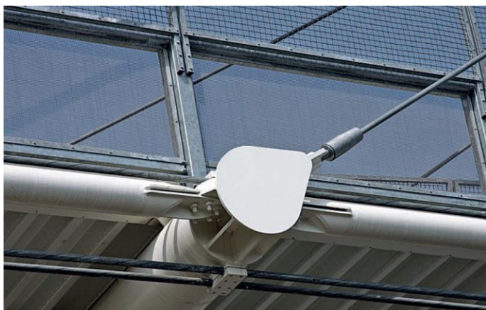
Figura 56 – Giunto bullonato tra i cavi provenienti dai cavalletti, le travi trasversali e i tubolari correnti
